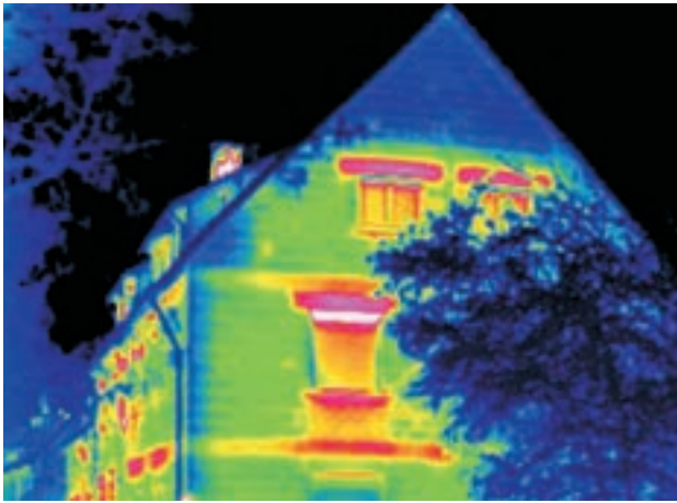
Thermografie: Wärmebrücken am Gebäude
