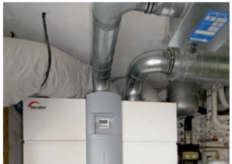
Lüftungsanlage mit Wärmepumpe
